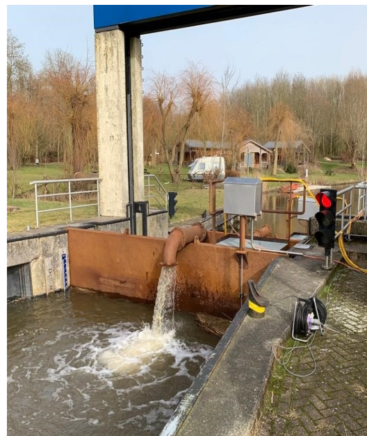
Figuur 5.2: Een van de twee stalen schotten van de tijdelijke vispassage bij keersluis HD Louwes. In het schot zijn rikketten aanwezig waar vissen doorheen kunnen zwemmen. De pomp zorgt voor een lokstroom.
