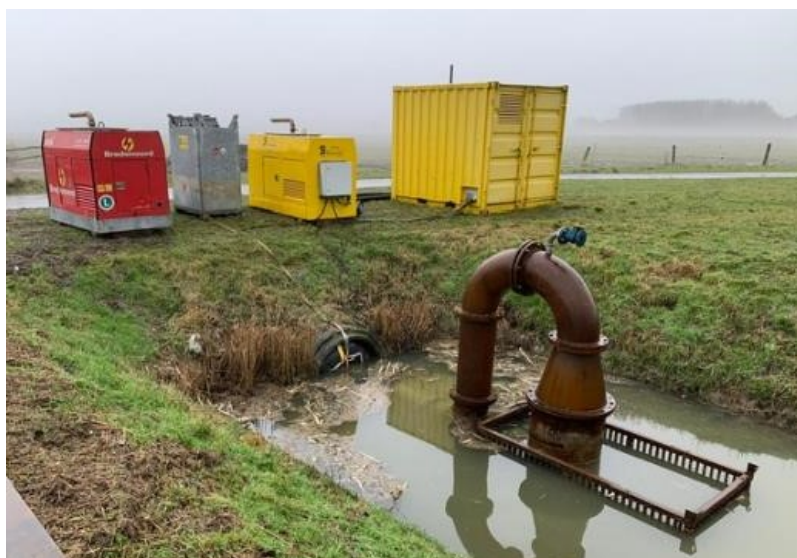
Figuur 6.1: De tijdelijke pompinstallatie op de locatie Ooster Nieuwskruisland
